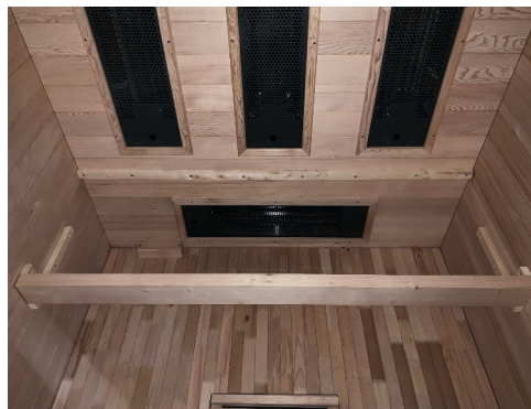
Inštalovaná podpora lavice
